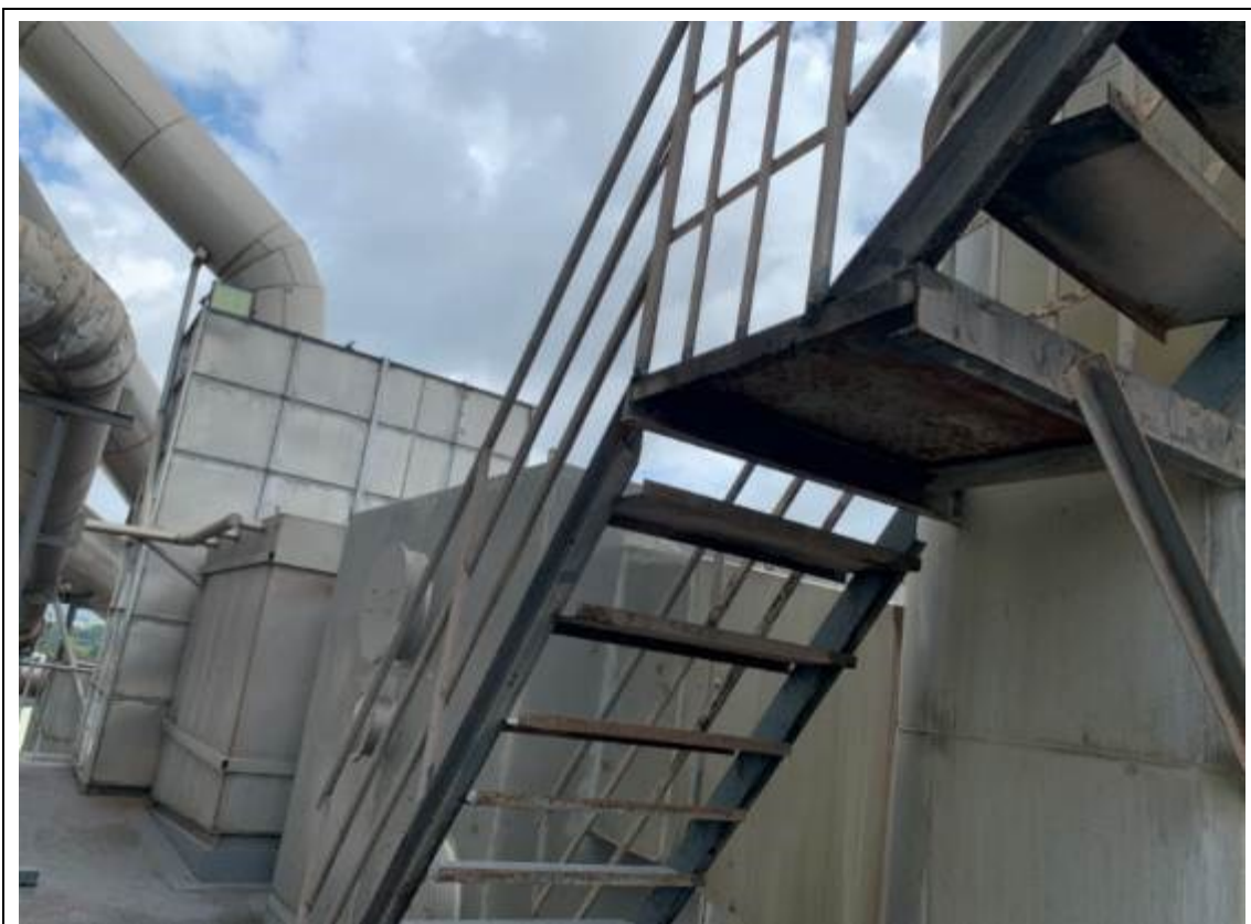
4 楼生物除臭系统
