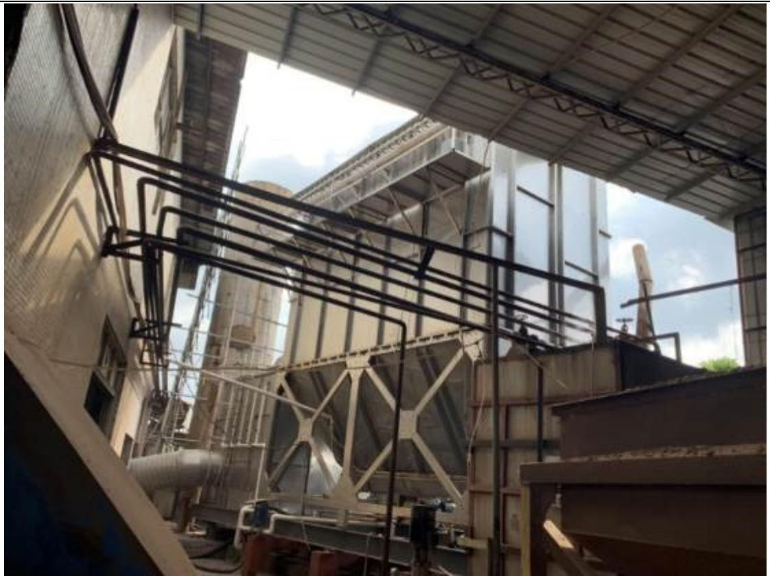
锅炉废气配套的脉冲袋式除尘器
