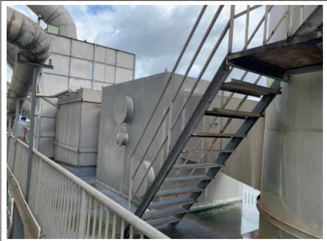
6 楼生物除臭系统
