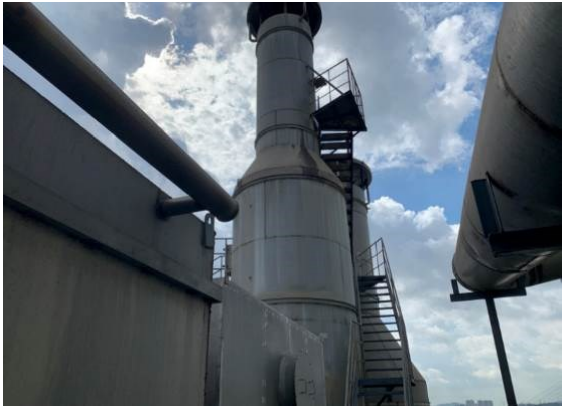
生物除臭系统末端的吸收塔
