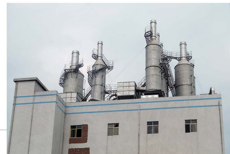
湛江海大喷淋除臭设备
