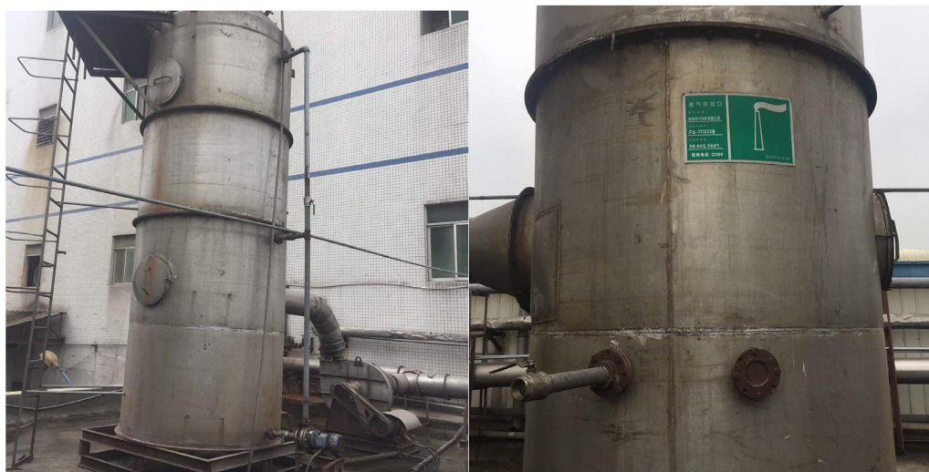
喷淋塔除尘装置
